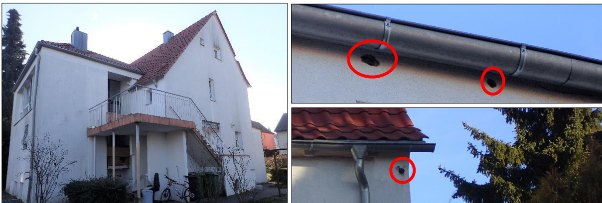
Abbildung 5: Wohnhaus in der Freiburger Straße 3 (linkes Bild, Westfassade) mit diversen Löchern in der Außenfassade (rechte Bilder, rote Ellipsen, unten mit Nutzungsspuren)
